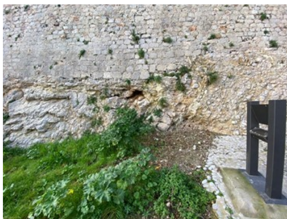
IMAGEN DEL DESGASTE DE LA BASE DE LA MURALLA
